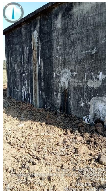
Figura 77 - Sinais de vazamento no reservatório
