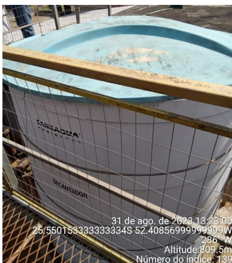
Figura 52 - Decantador da ETA compacta
