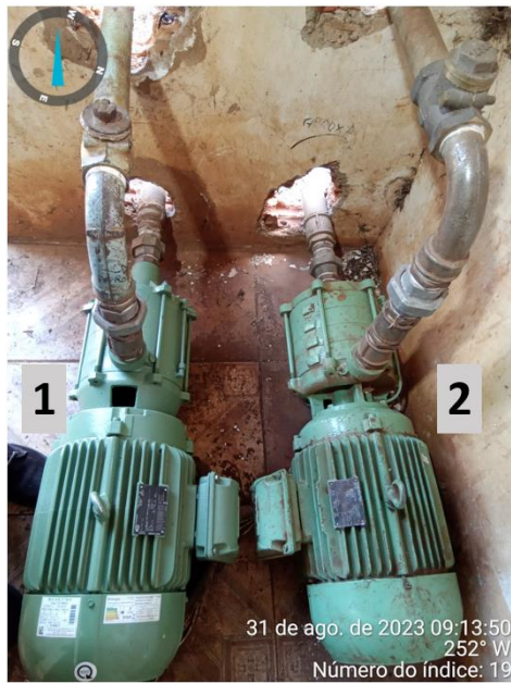
Figura 37 - Bombas elevatórias do poço 1 (SEDE)
