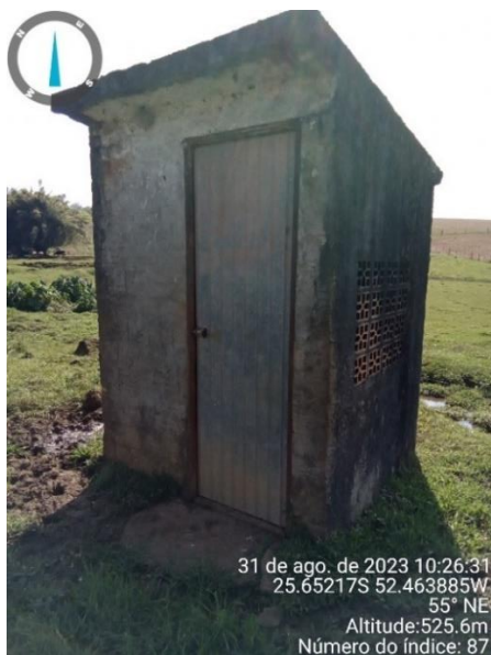
Figura 29 - Casa de comando do poço 2 (frente)
