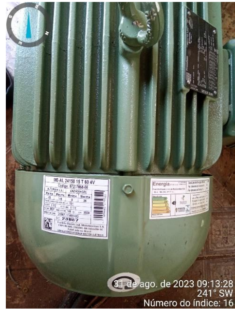
Figura 38 - identificação da bomba 1 no poço 1
