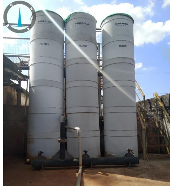
Figura 55 - Filtros da ETA compacta
