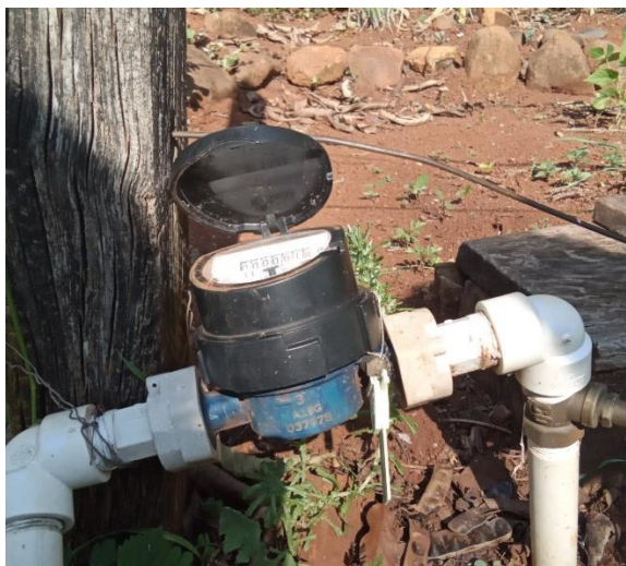
Figura 78 - Identificação do hidrômetro P01
