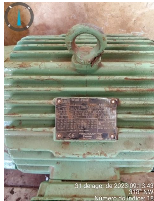
Figura 40 - Identificação da bomba 2 no poço 1
