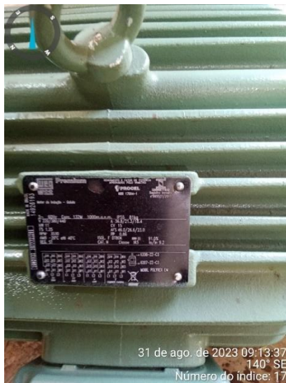
Figura 39 - Identificação de equipamento da bomba 1 no poço 1
