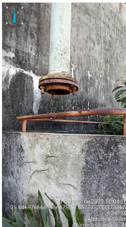
Figura 75 - Saída de água sem proteção (tela)
