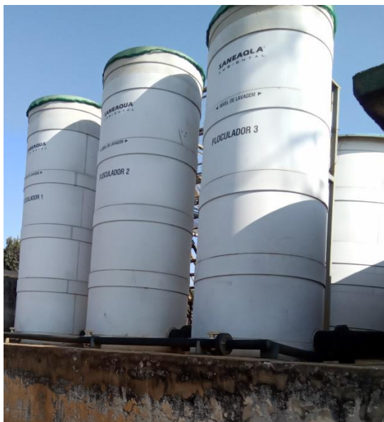
Figura 50 - Flocuradores da ETA
