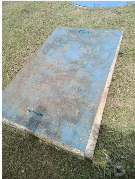
Foto 132– Tampa elevatória ETE
