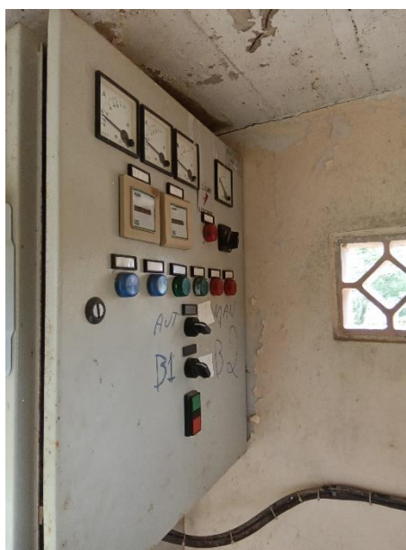
Foto 106 – Frente do quadro de comando EEA 05
