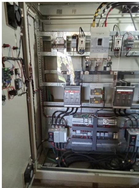
Foto 80 – Lado esquerdo quadro de comando EEA Rios
