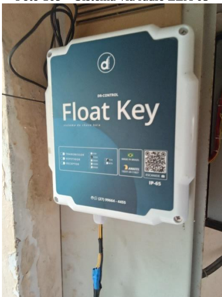
Foto 109 – Sistema via rádio EEA 05
