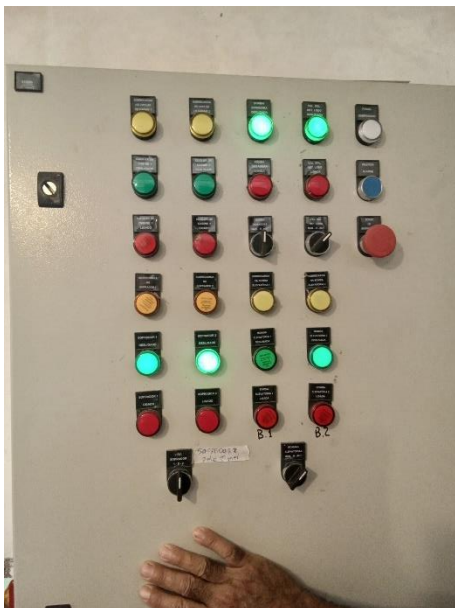
Foto 137 – Frente do quadro de comando
