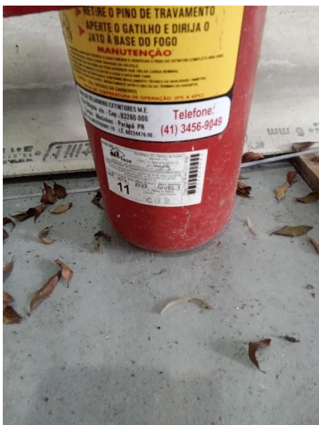
Foto 113 – Extintor EEA 02 vencido (abril/2023)
