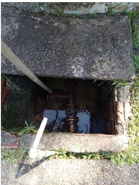
Foto 57 – Registros RAP Bairro Alto com vazamentos
