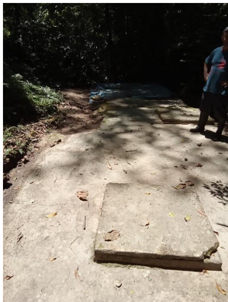
Foto 63 – Reservatório Captação Matarazzo
