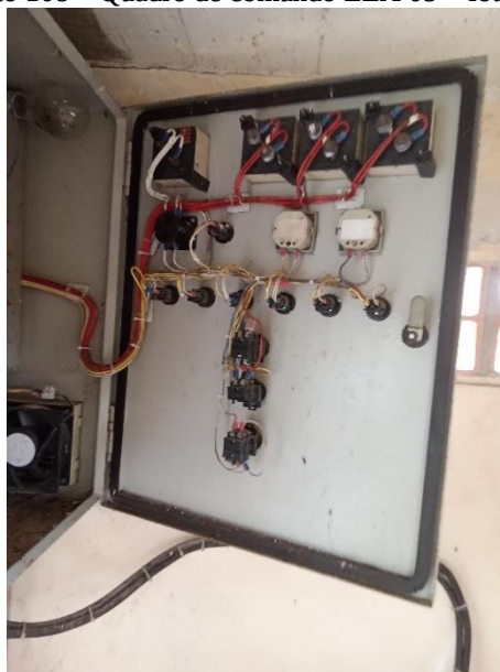
Foto 108 – Quadro de comando EEA 05 – foto 02
