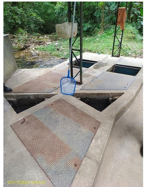
Foto 20 – Captação rio Jantador
