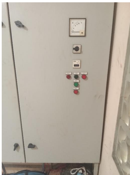
Foto 120 – Frente quadro de comando EEA 06 – lado direito
