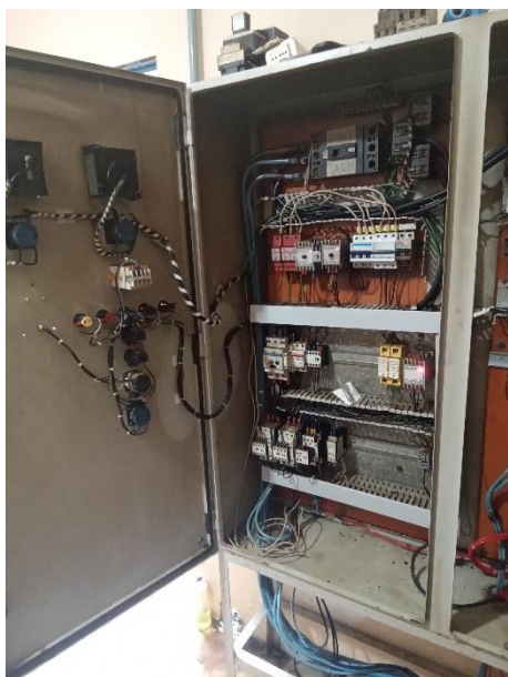
Foto 121 – Quadro de comando lado esquerdo EEA 06
