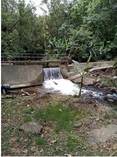
Foto 17 – Barragem de nível captação rio Xaxim
