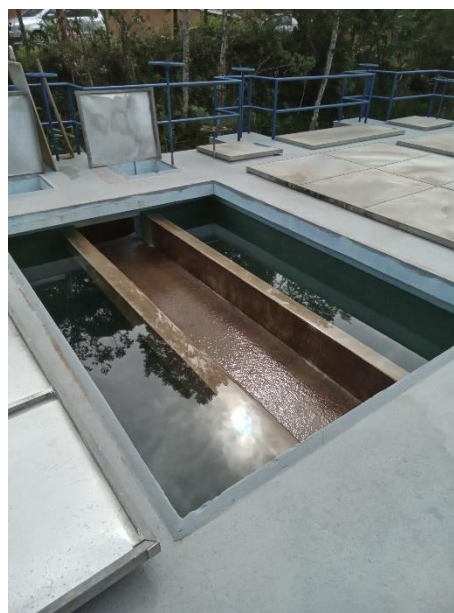
Foto 48 – Filtro de fluxo ascendente (ETA Itapema)
