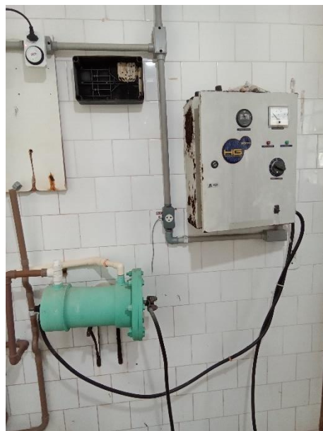
Foto 40 – Frente do painel de comando UTA Itapema
