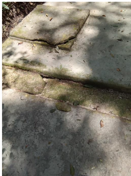
Foto 64 – Tampa reservatório captação Matarazzo
