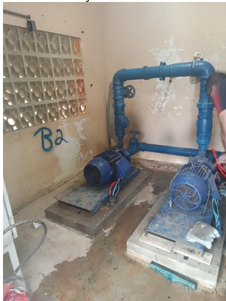
Foto 118 – Conjunto moto bomba EEA 06
