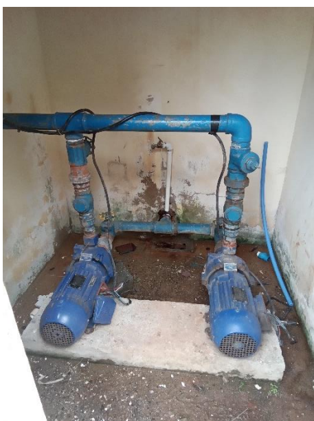
Foto 105 – Conjunto moto bomba EEA 05
