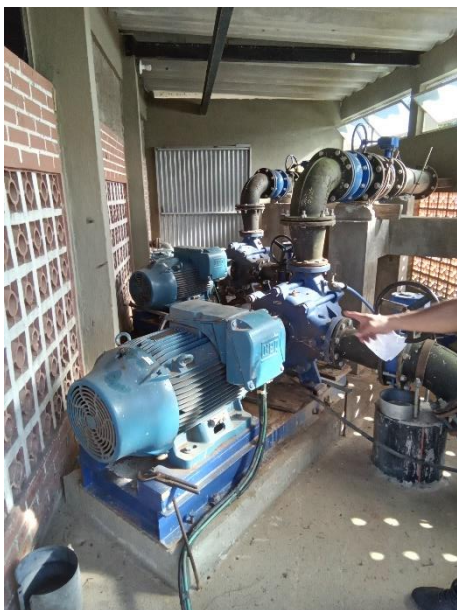
Foto 77 – Elevatória (casa de bombas) – EEA Rios
