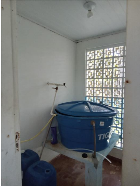
Foto 33 – UTA Bairro Alto (tanque de cloro)
