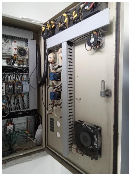
Foto 116 – Quadro de comando EEA 02 – foto 02
