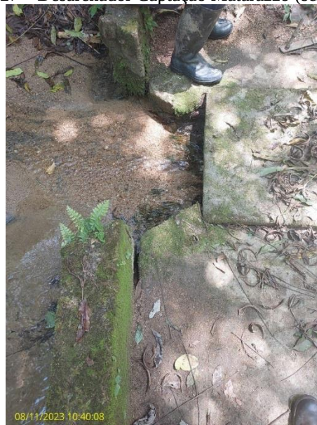
Foto 27 – Desarenador Captação Matarazzo (sem tela)
