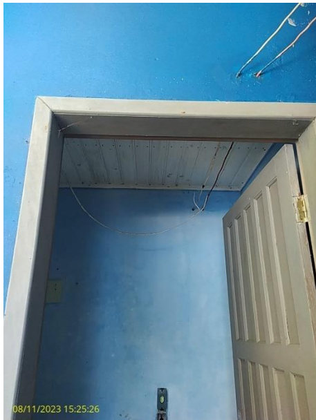
Foto 41 – Falta de identificação UTA Itapema 2
