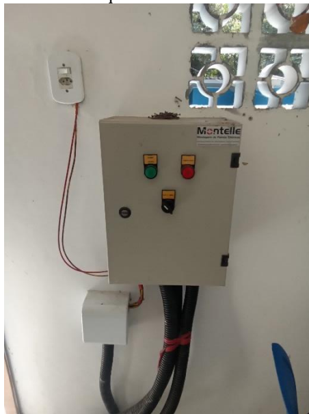
Foto 86 – Frente do quadro de comando EEA Itapema 2
