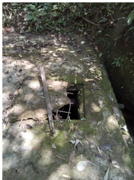
Foto 29 – Tampas da caixa captação Maurício
