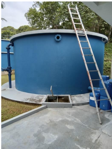
Foto 61- RAP1 ETA Itapema (extravasador sem tela)
