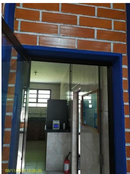
Foto 125 – Falta de identificação
