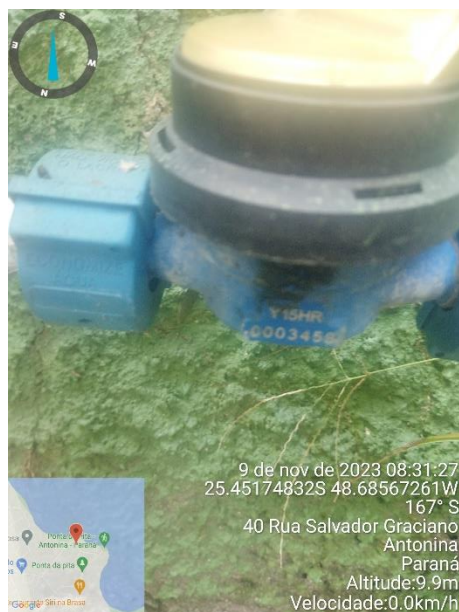
Foto 114 – Identificação hidrômetro P01 (2015)
