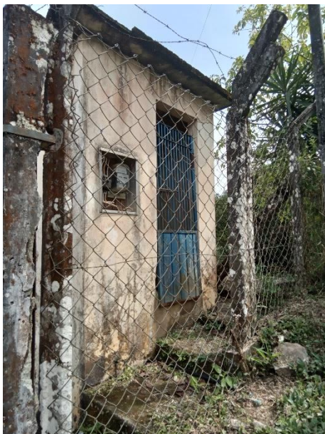
Foto 103 – Falta de manutenção EEA 05
