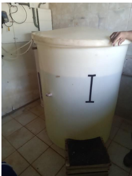
Foto 45 – Tanque de cloro UTA Central
