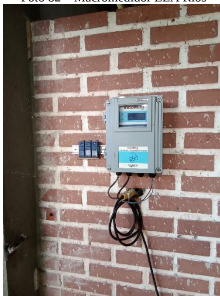
Foto 82 – Macromedidor EEA Rios
