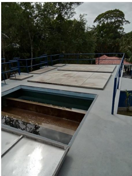
Foto 49 – Filtros de fluxo ascendente (ETA Itapema)
