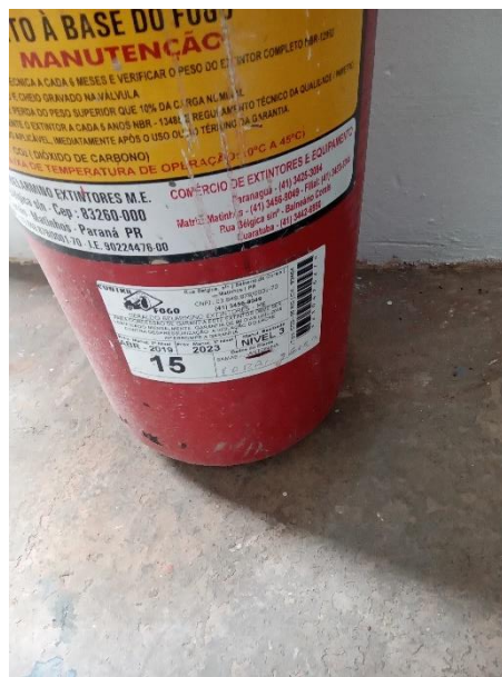
Foto 100 – Extintor EEA 04 (validade abril/2023 – vencido)
