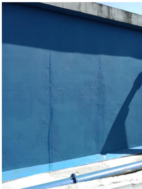
Foto 67 – Problemas impermeabilização RESENT Itapema
