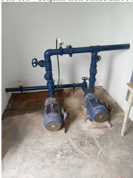
Foto 101 – Conjunto moto bomba EEA 04
