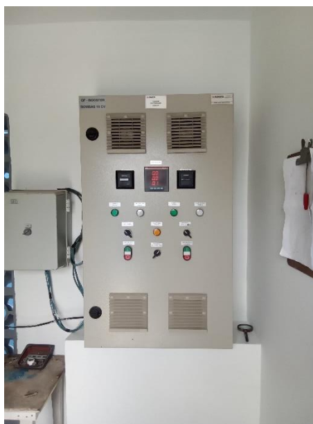
Foto 98 – Frente do quadro de comando EEA 04
