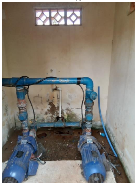
Foto 104 – Espaço interno inadequado para operador EEA 05
