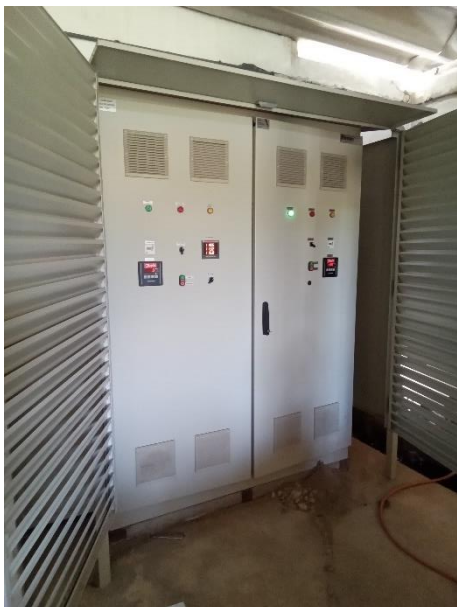
Foto 79 – Frente do quadro de comando – EEA Rios
