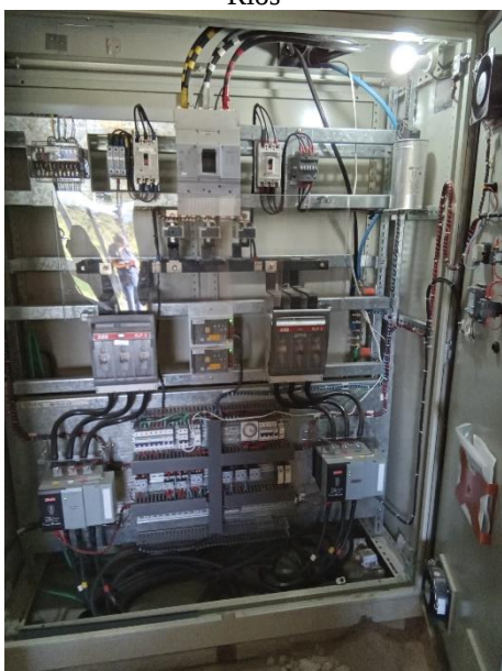
Foto 81 – Lado direito quadro de comando EEA Rios
