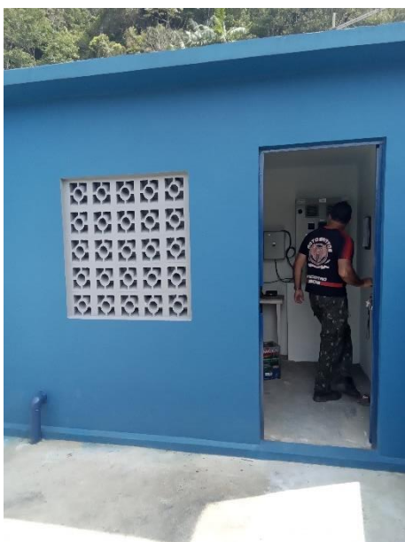
Foto 97 – EEA 04 – falta identificação
