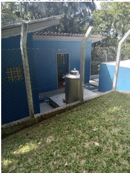
Foto 51 – Filtro ETA Itapema 2
