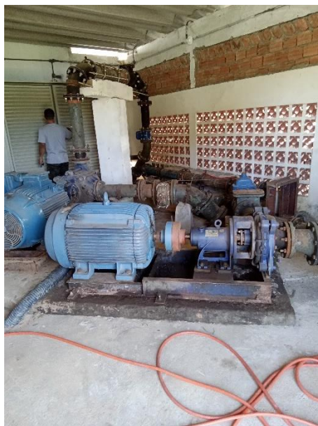
Foto 78 – Conjunto Moto Bomba – EEA Rios
