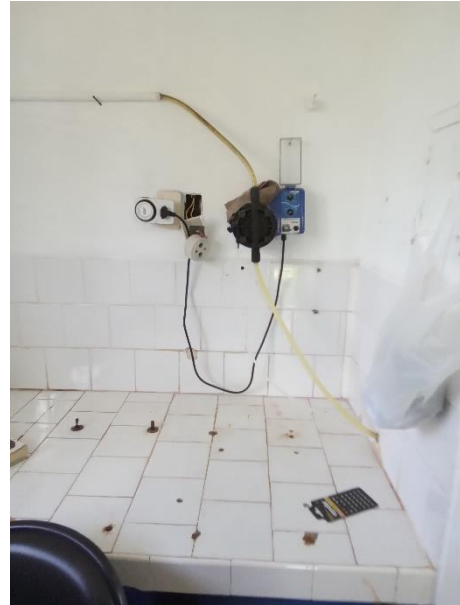
Foto 34 – Bomba dosadora UTA Bairro Alto
