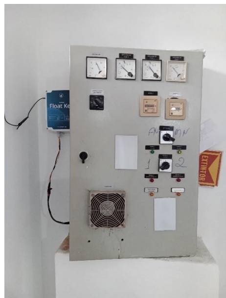
Foto 114 – Frente do quadro de comando EEA 02
