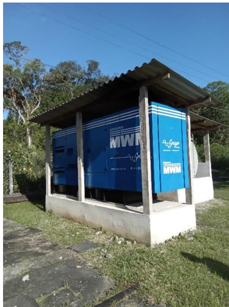
Foto 84 – Gerador EEA Rios
