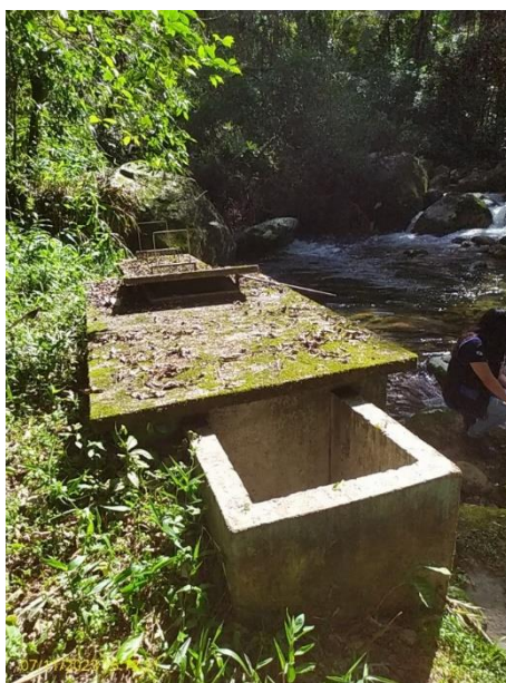
Foto 30 – Captação rio Cotia
