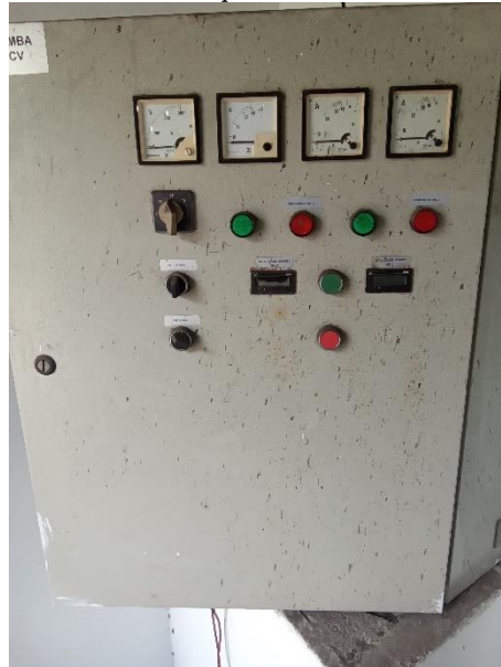
Foto 92 – Frente do quadro de comando EEA 03
