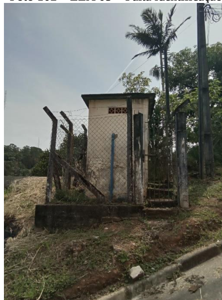
Foto 102 – EEA 05 – Falta identificação
