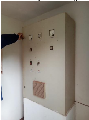
Foto 29 – Quadro de energia
