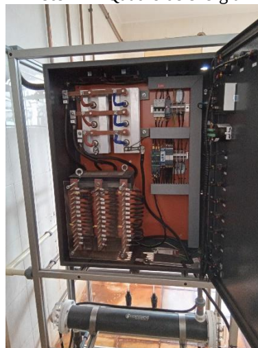
Foto 24 – Quadro de energia
