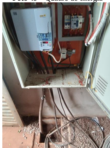
Foto 49 – Quadro de energia
