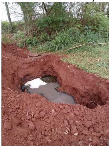
Foto 93 – Dano na tubulação
