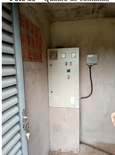
Foto 55 – Quadro de comando
