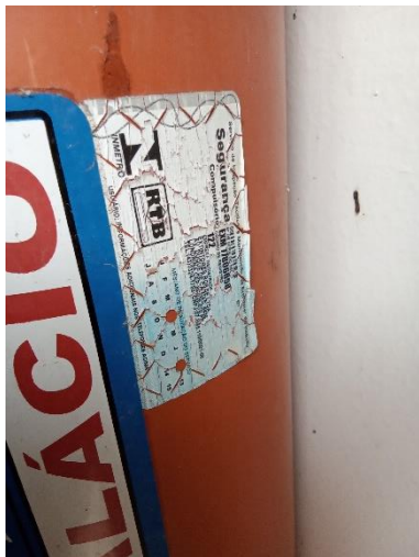
Foto 21 – Extintor validade vencida
