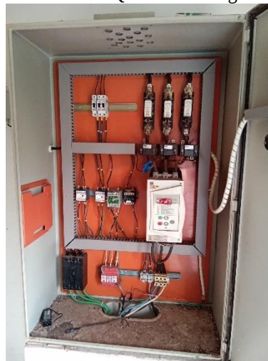
Foto 30 – Quadro de energia
