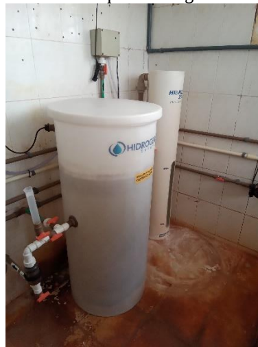
Foto 22 – Tanques de reagentes UTA
