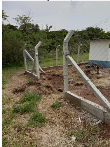
Foto 34 – Ausência de portão (em fase de instalação)
