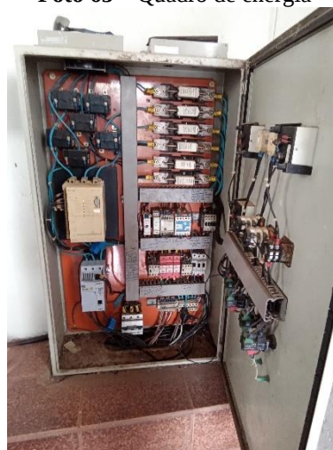
Foto 65 – Quadro de energia
