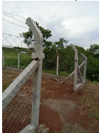
Foto 32 – Acesso sem portão
