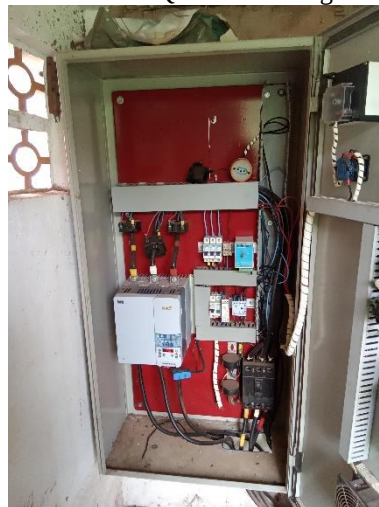
Foto 43 – Quadro de energia
