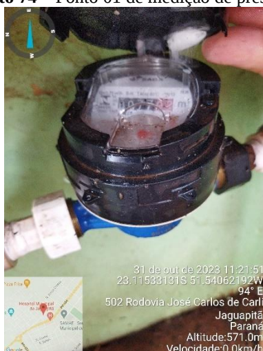
Foto 74 – Ponto 01 de medição de pressão
