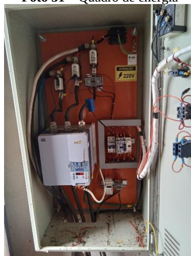
Foto 51 – Quadro de energia
