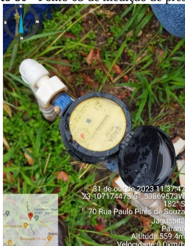
Foto 80 - Ponto 03 de medição de pressão
