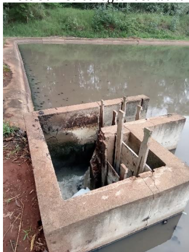
Foto 90 – Saída lagoa facultativa
