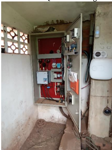
Foto 42 – Quadro de energia
