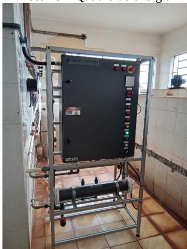
Foto 23 – Quadro de energia
