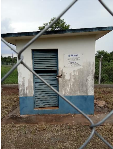
Foto 25 – Poço 02 porta com avarias
